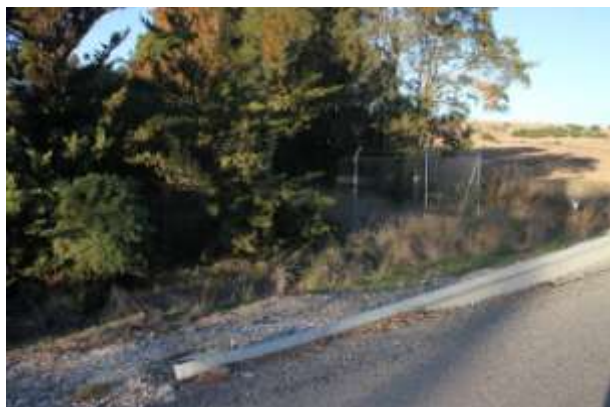
Detalle de barreta metálica y cerramiento de parcela. Requieren desmontaje previo y reposición.
